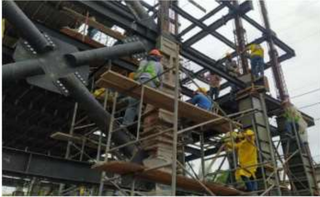
Fundida de columnas 2o tramo en doble altura eje 5 G a I
